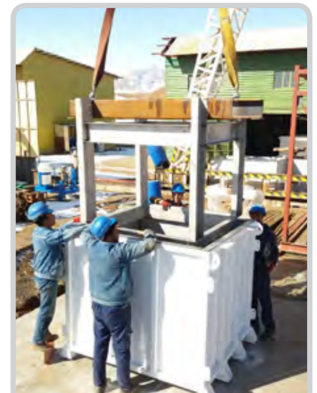
ساخت خط تولید غشاهای جداسازی گاز در شرکت ماشین‌سازی گاز کرینیک شهرکرد
